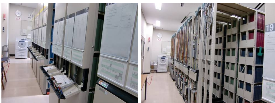
電動集密書架の故障とリプレイス作業中の様子
